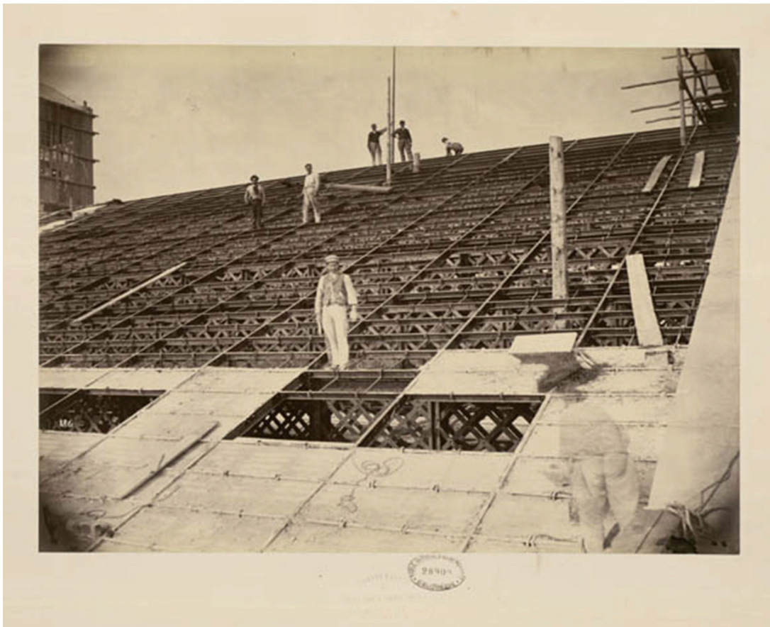
2.18. Louis-Émile Durandelle, Construction of the Nouvel Opéra, Paris, The “Phantom of the Opéra” and workers on the roof, 1869. Albumen print. École nationale supérieure des Beaux-Arts Ph 270.
